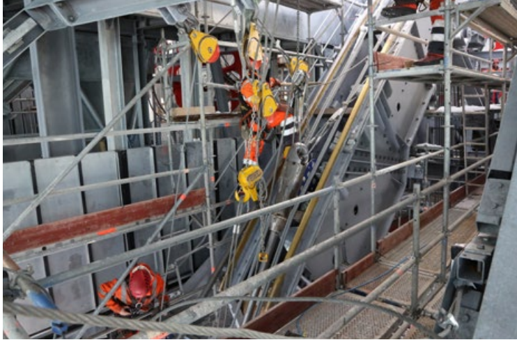
Seilzug eines Tragseils Quelle: Bayerische Zugspitzbahn
