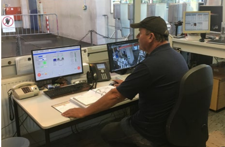
Betriebsleiter am Steuerstand Quelle: StMB
